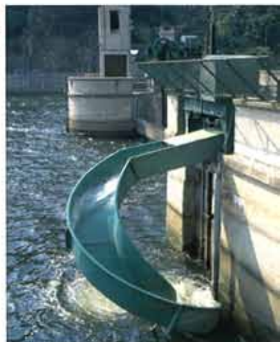
Ascenseur et glissière à saumons au barrage de Poutes sur l'Allier (Haute-Loire).
