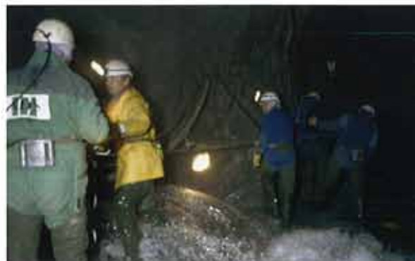
Les travaux effectués sur le site de l'ouvrage de captage des eaux glaciaires à Chamonix (Haute Savoie).
