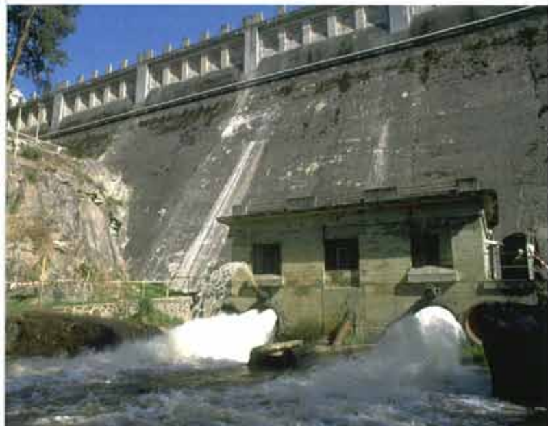
Vanne de vidange du barrage de Crescent (Yonne).
