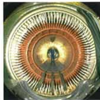
Alternateur d'une centrale électrique.
